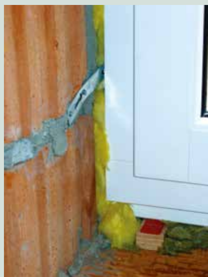
Statt mit schleimhautreizendem Polyurethan, wurde dieser Türrahmen mittels Schrauben befestigt – Mineralwolle kleidet die Hohlräume aus.
