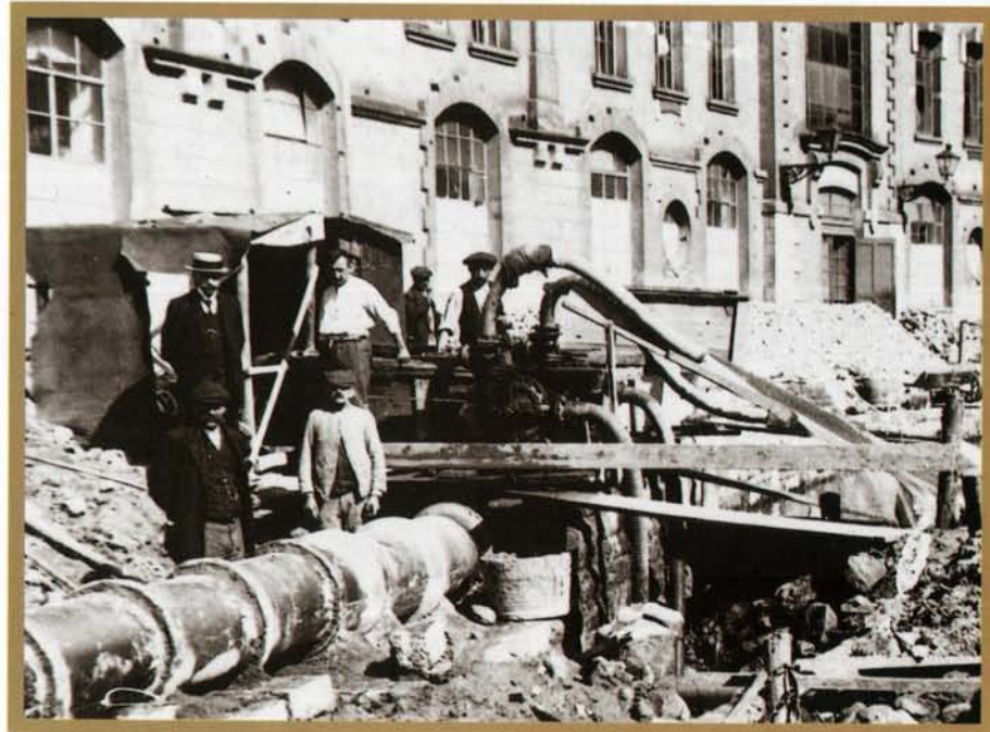
Verlegung des Hauptkollektors in Stadtgrund im Jahre 1920. Im Hintergrund erkennt man die „Händschefabrik“
