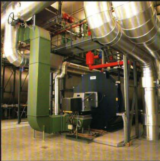
Chaudière à gaz
