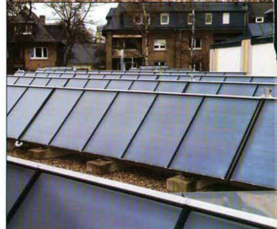
Panneaux solaires Ecole Batty Weber
